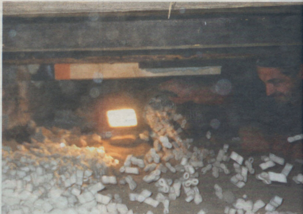
Een werknemer van Gebroeders De Vries aan het werk in een kruipruimte. Dit isolatiebedrijf werkt het liefst met chips van piepschuim. FOTO GEBROEDERS DE VRIES, DOKKUM
